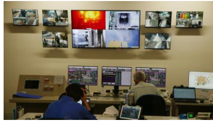
モニターで作業の様子がわかる制御室
